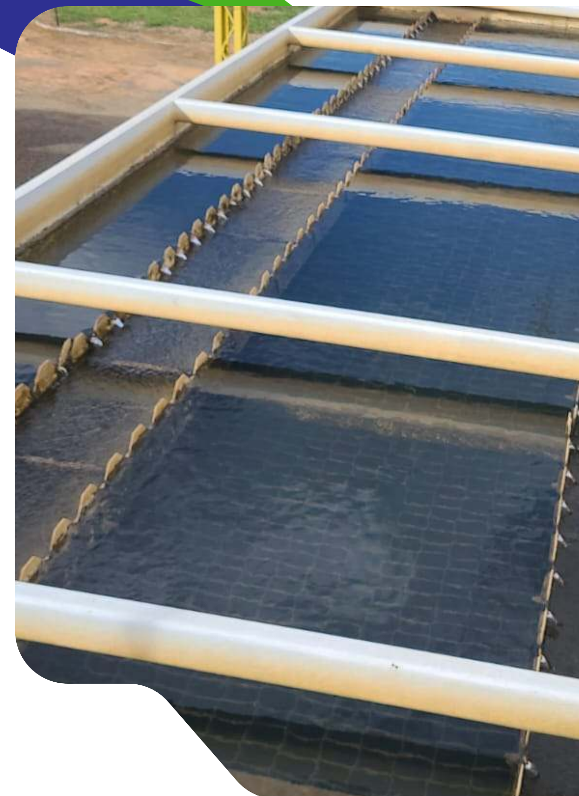
Estação de tratamento de água. Abatedouro de aves, Palmeiras de Goiás - GO.
